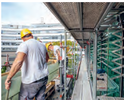
Riesiges ReUse-Projekt: Diese 55 Tonnen Glaslamellen werden am Medienhaus Werd abmontiert und kommen dereinst an die Fassade unserer Siedlung Koch.
